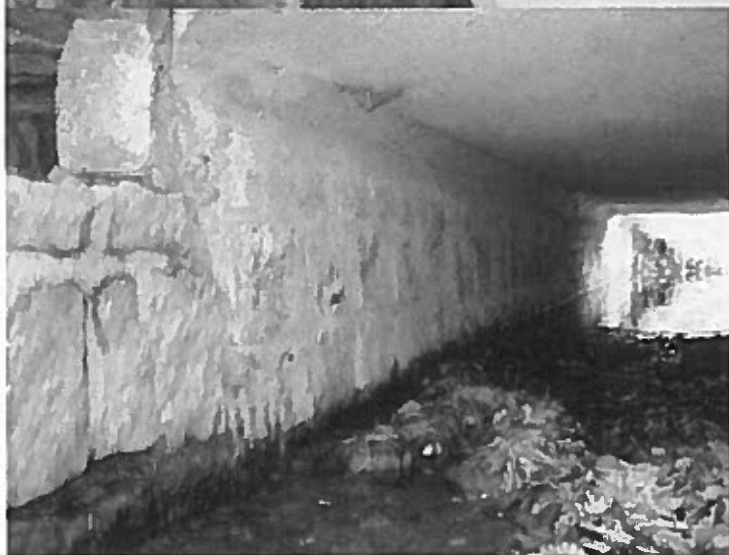
Sinice na kamenném obkladu opěry 2. Patrná je nerovnost spodního líce NK.
