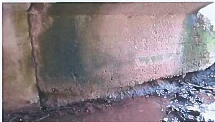
Rozpad ve spodní části a částečné podemletí podpěr u rozšířené části objektu
