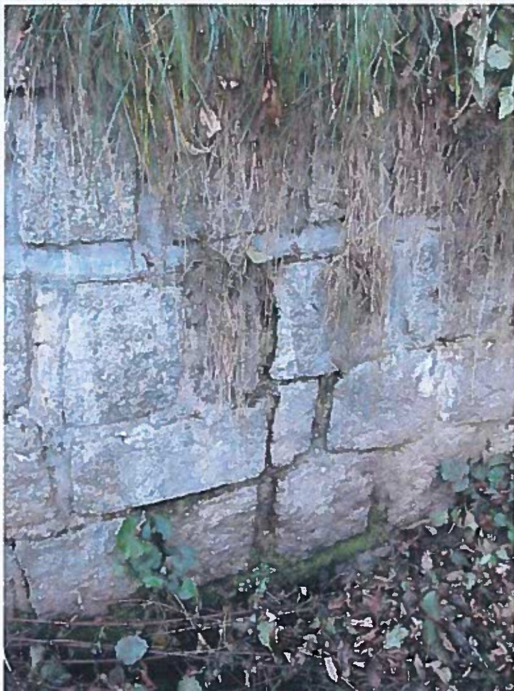
Vypadávající spárování + vegetace ve spárách.
