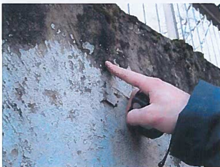
Nedostatečné krytí - levá římsa.
