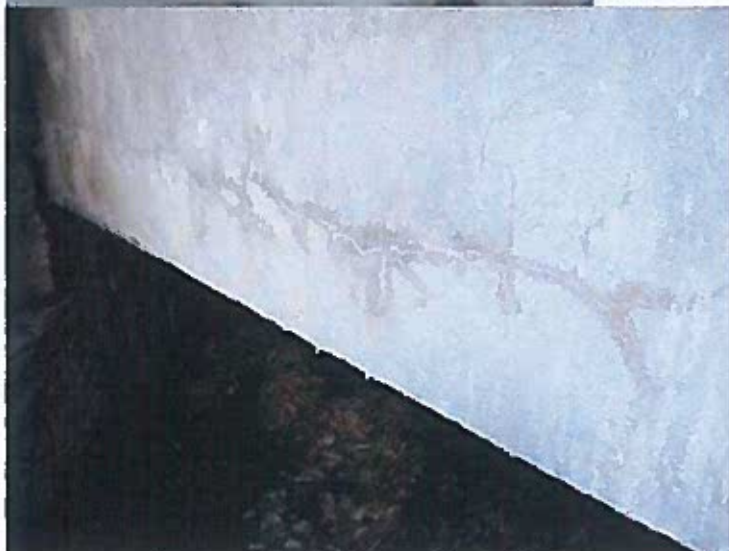
Trhlina + vyluhy na boku NK.
