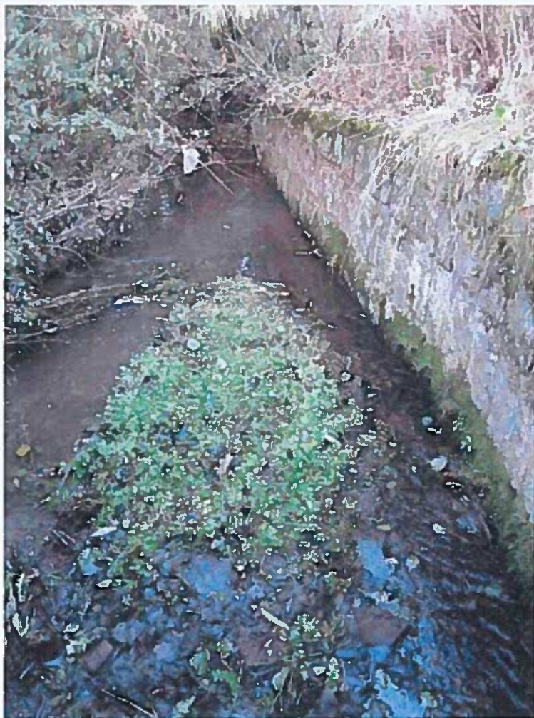
Zanesené koryto potoka va výtoku.
