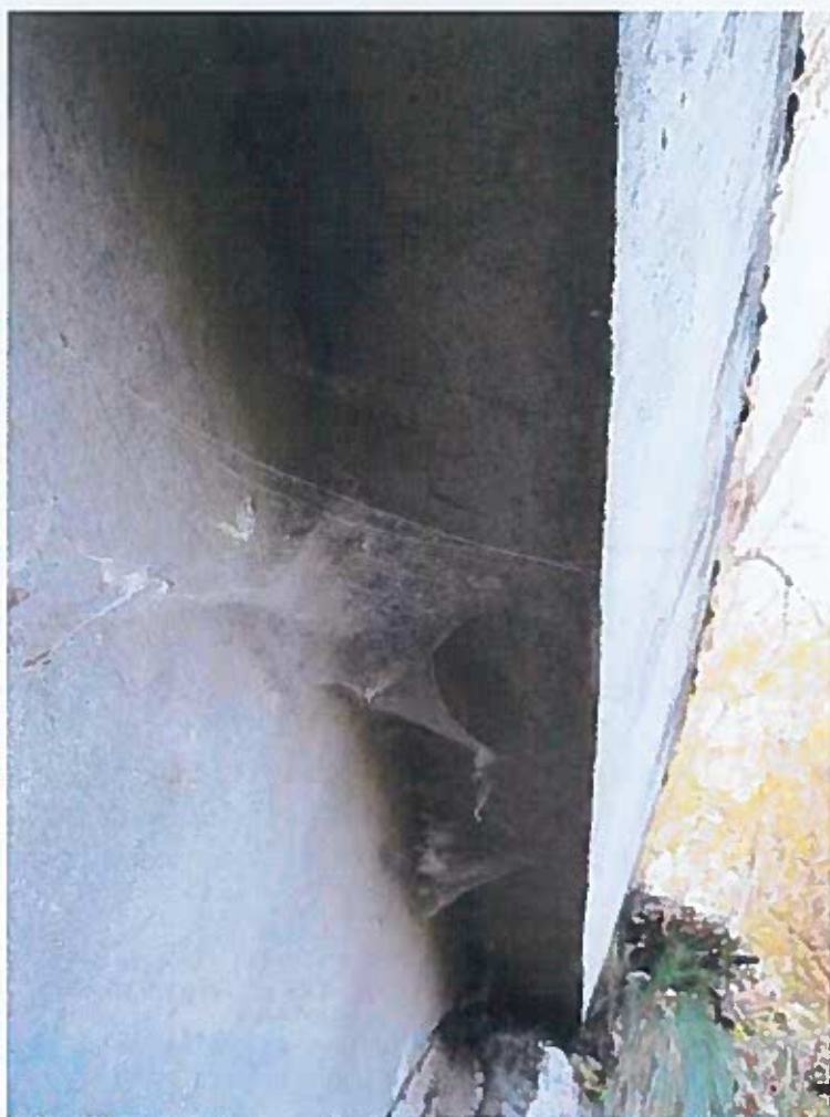
Chybějící okapnička na spodním povrchu levé římsy.
