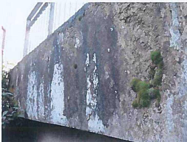
Degradovaný povrch betonu levé římsy.
