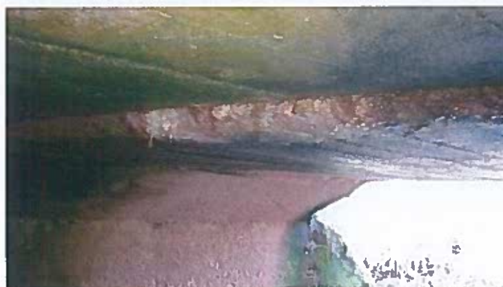
Spára mezi původní a rozšířenou částí mostu, vzájemný posun
