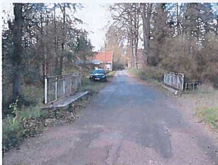
Pohled na most proti směru staničení. U na styku vozovky a říms jsou patrné nánosy a listí.
