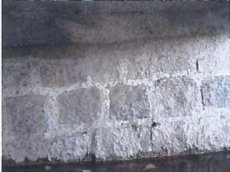
Kamenný obklad opěry - patrné je znečištění obkladu torkretovou omítkou.
