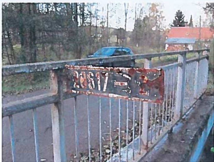
Korozí postižená tabulka s ev. č. mostu.
